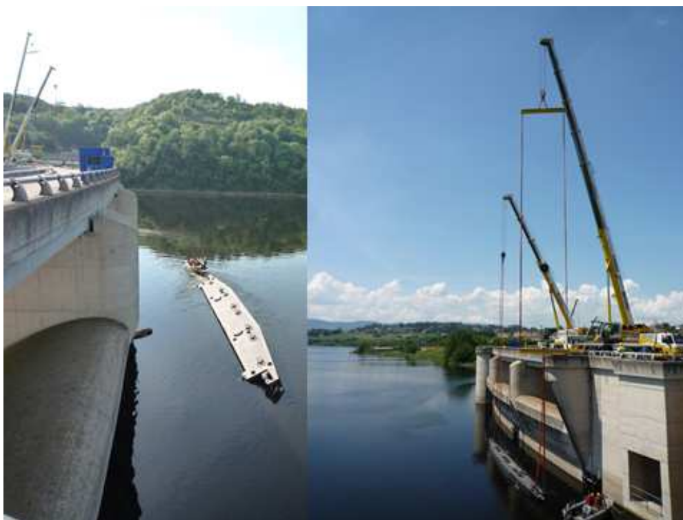
Elément remorqué par bateau puis positionné au droit du pertuis à batardeur
