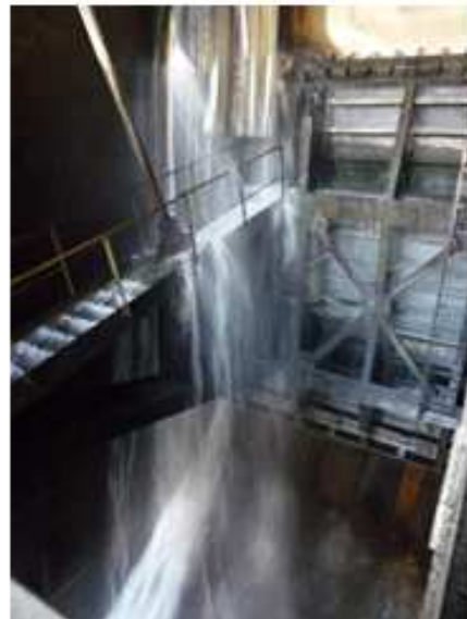
Fuite de la VS2 AVANT les travaux
