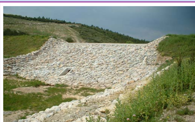
Ouvrage de protection contre les crues de Nîmes ORD avec digue en remblai et déversoir de crue en enrochements
